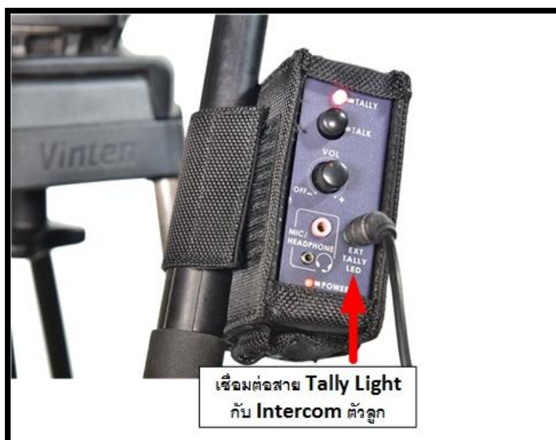
ภาพที่ 4-24 การเชื่อมต่อสาย Tally Light ของกล้องกับ Intercom ตัวลูก
