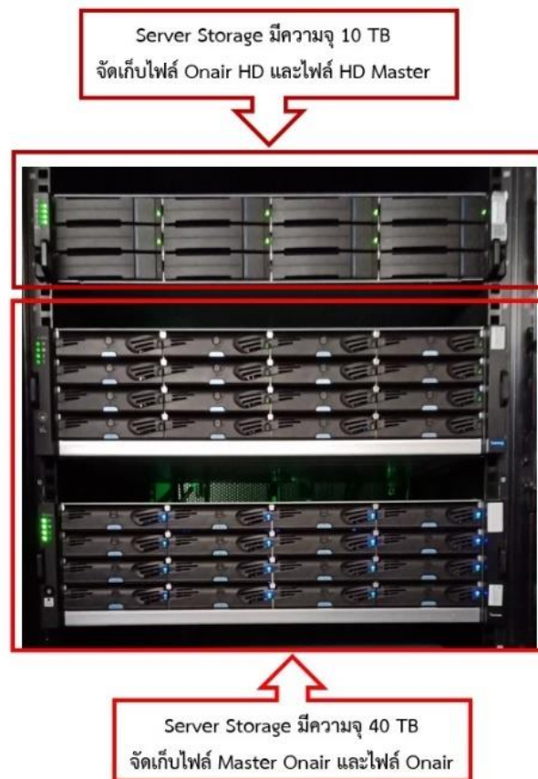
ภาพที่ 3-21ขนาดของอุปกรณ์ระบบจัดเก็บข้อมูล (Storage Server)
