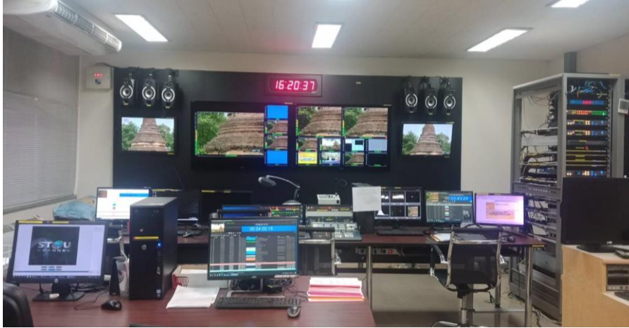
ภาพที่ 3-3 ห้องควบคุมระบบการออกอากาศช่องรายการ STOU Channel
